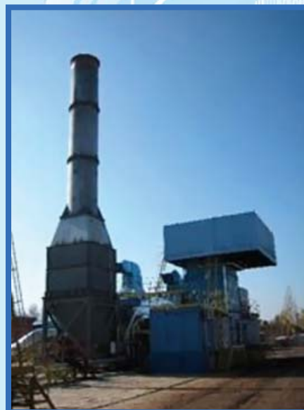
Газоперекачивающий агрегат на компрессорной станции «Пермская»
