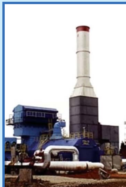
Газоперекачивающий агрегат мощностью 16 МВт
