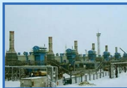
Дожимной газоперекачивающий агрегат мощностью 16 МВт на компрессорной станции «ПО «Ямбурггаздобыча»
