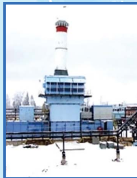
Газоперекачивающий агрегат для подземных хранилищ мощностью 10 МВт на компрессорной станции "Карашурская"
