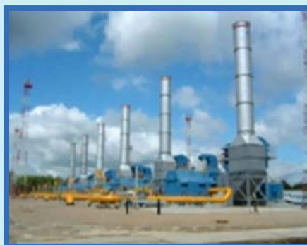
Газоперекачивающий агрегат мощностью 16 МВт на компрессорной станции «Смоленская»
