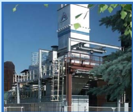
Газотурбинная электростанция мощностью 2,5 МВт
