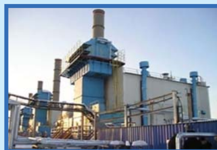
Дожимной газоперекачивающий агрегат мощностью 16 МВт на компрессорной станции «Западно-Таркосалинская»
