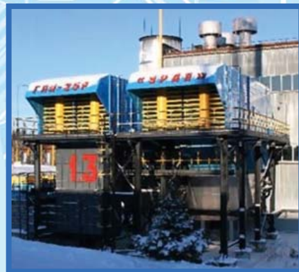
Газоперекачивающий агрегат на компрессорной станции «Игринская»
