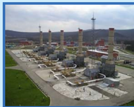
Газоперекачивающий агрегат мощностью 12 МВт на компрессорной станции «Краснодарская»
