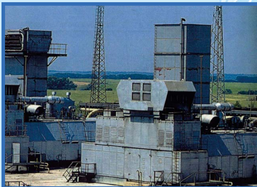
Газоперекачивающий агрегат на базе двигателя мощностью 8 МВт
