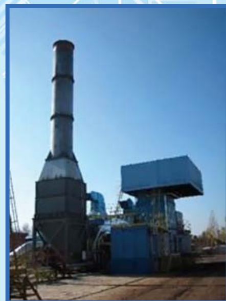
Газоперекачивающий агрегат на компрессорной станции «Пермская»
