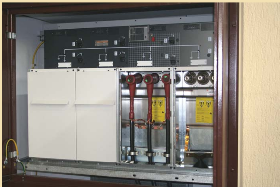
Отсек распределительного устройства высшего напряжения (УВН)
